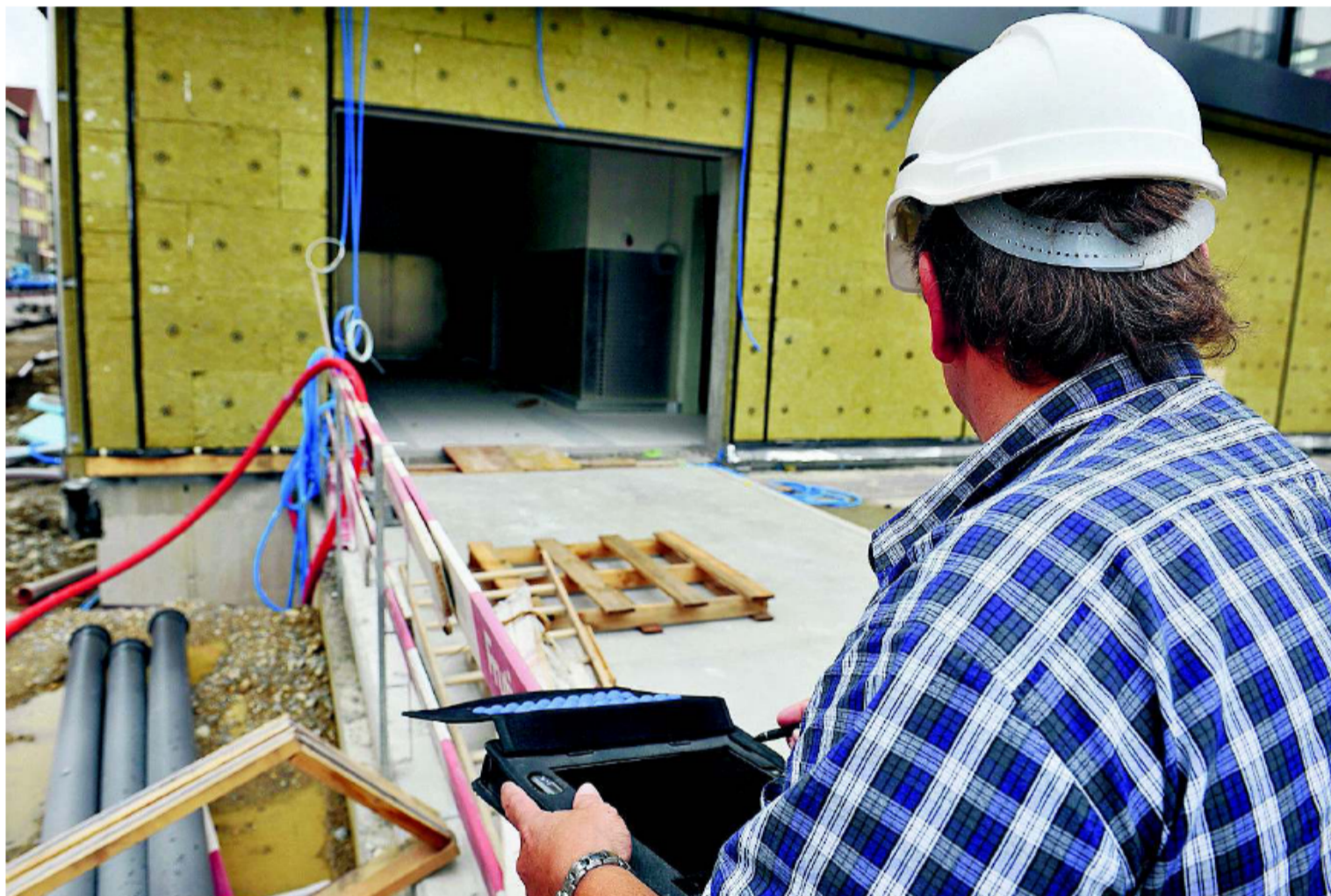
Der Arbeitskontrolleur stellt auf den Baustellen viele Verstösse gegen GAV-Bestimmungen fest. ARCHIVOM
